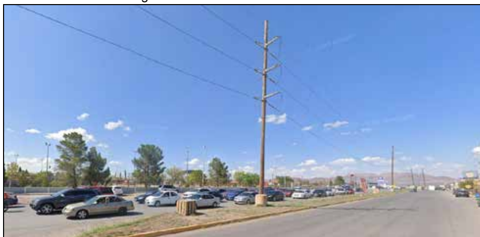
Imagen 51. Red eléctrica en Av. Los Arcos.
