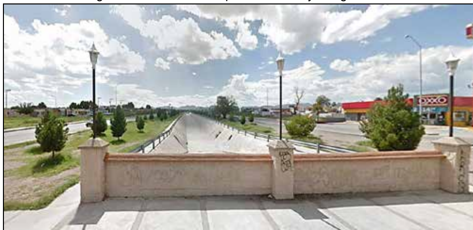
Imagen 57. Infraestructura pluvial del Arroyo Nogales norte.
